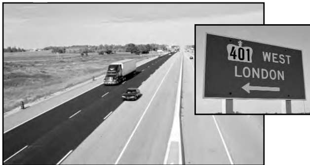
Photo A-10 : Le tronçon utilisé pour l'essai du procédé de recyclage à chaud entre Woodstock et London.
