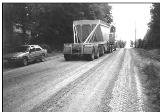
a) Mise en place de matériau granulaire supplémentaire par-dessus le vieux revêtement préalablement pulvérisé.
