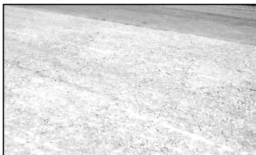
b) Aspect de la surface du BCP fracturé, avant compactage.
