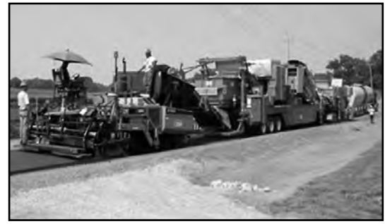
Photo 3-7 : Chaîne au bitume moussé de recyclage de couche de surface posée au finisseur.
