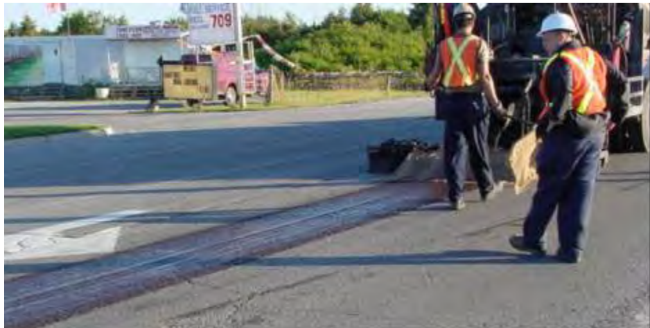
Figure 3-8 : Le prétraitement de faïençage modéré à la ligne médiane avec une bande de microrevêtement avant l'application d'une assise régulière de microrevêtement sur toute la surface. (Gracieuseté du ministère des Transports de l'Ontario.)
