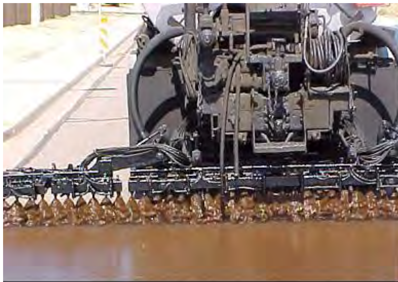
Figure 3–13 : Épandeur d’asphalte procédant à l’application d’une émulsion; vue de l’arrière. L’émulsion est habituellement de couleur brune et devient noire à mesure que se fait la cure de l’émulsion. Les buses de la rampe d’épandage assurent de multiples recouvrements de la surface.
