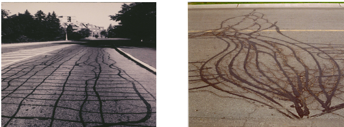
Figure 2-2 : Tronçons de chaussée ne convenant pas au calfeutrage des fissures.
